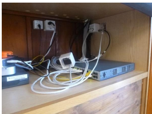
Installation dépourvue de rack informatique
