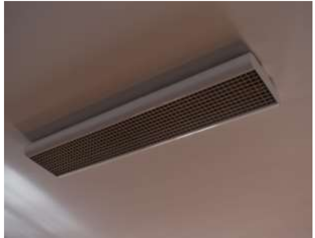
Luminaire – Salle des Sociétés
